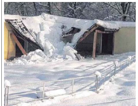
Die Schneemassen haben im Winter den Schafstall auf dem Argenhof einstürzen lassen.
